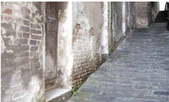
Zerstörung des Putzes und der Mörtelfugen
